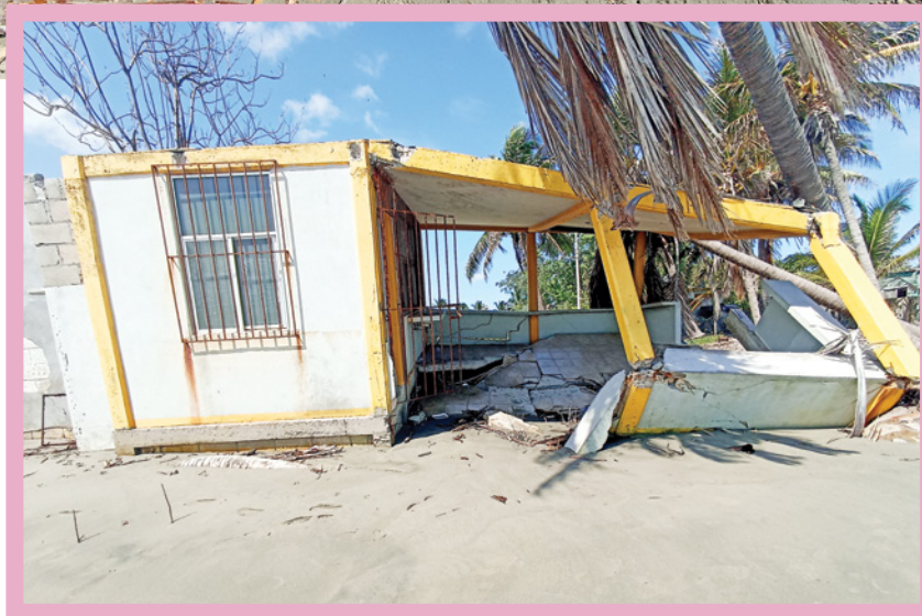
Restos de casas que se desmoronaron por el impacto del oleaje y la erosión costera. Crédito: Yessenia Sánchez Melo.
